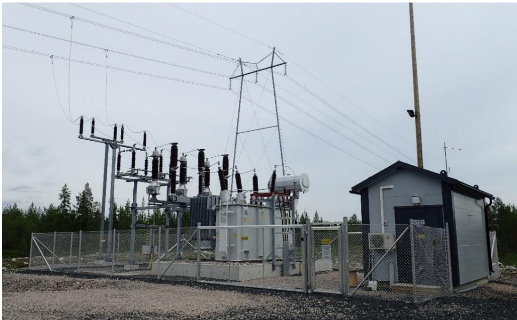
Kuva 20. Esimerkki tuulivoimapuiston sähköasemasta.
