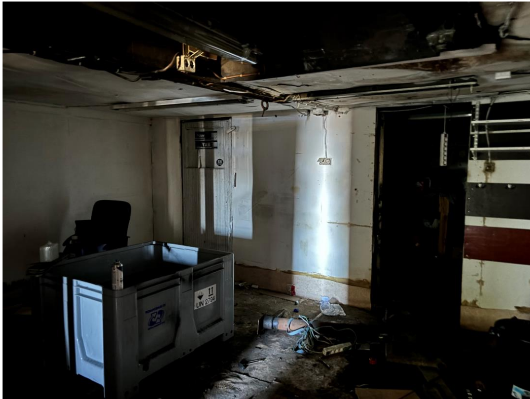
Työtila / takatila. Pintamateriaalit uusittava, hajut imeytyneet materiaaleihin.
