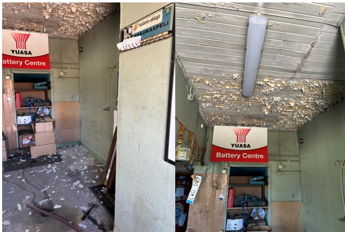
Välikaton kosteus irrottanut maalin katosta.
