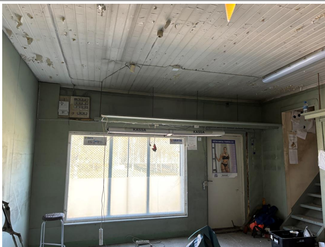
Välikaton kosteus irrottanut maalin katosta.
