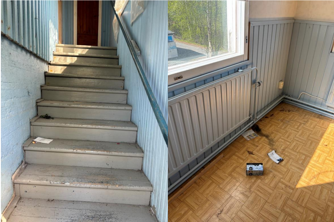
Portaikun runko pettänyt. Patteriverkosto vuotanut useammasta kohdasta.
