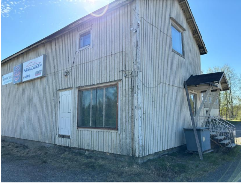
Ulkovuori rapistunut ja lahonnut. Portaat puuttuvat.
