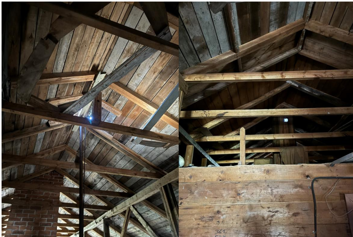
Vesikate on vuotanut ja katossa on reikiä.
