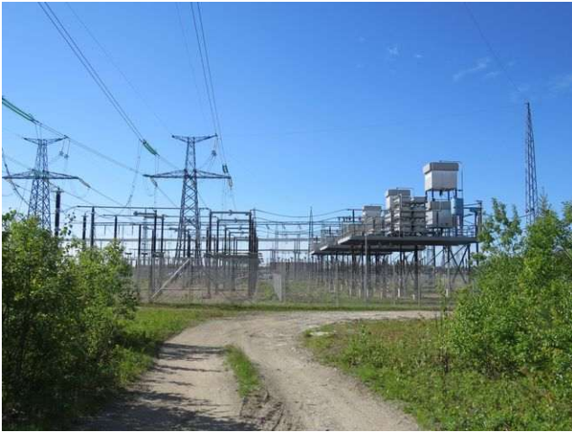
Kuva 45. Keminmaan sähköasema etelään.
