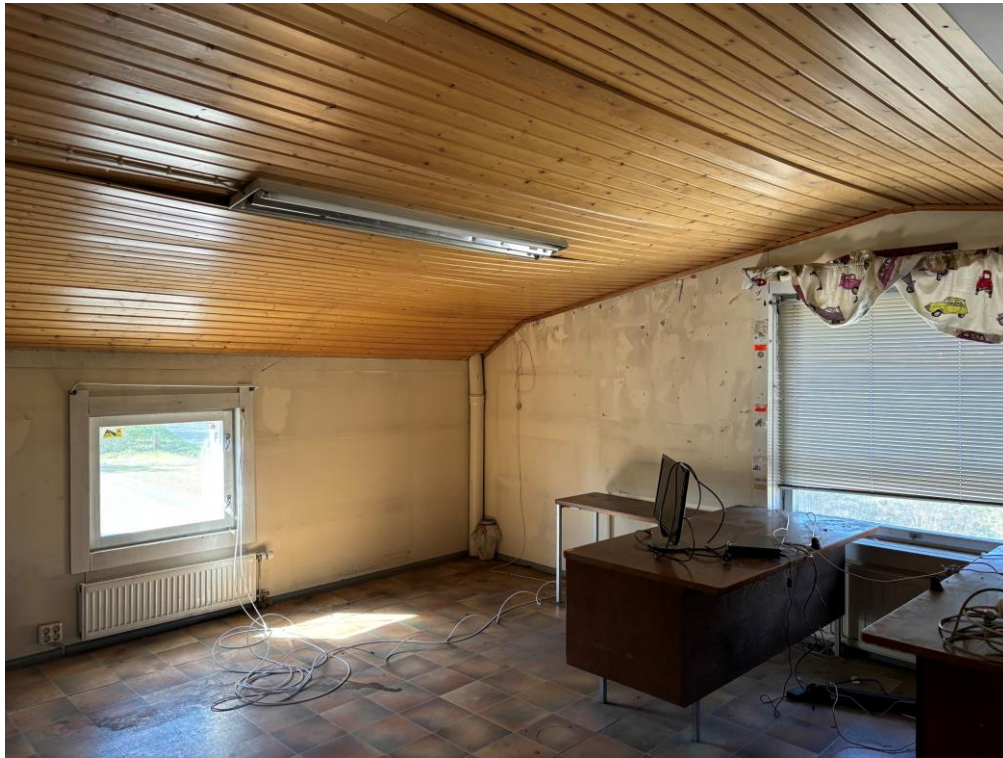
Kattorakenne myödannt, tilan korkeus matala.
