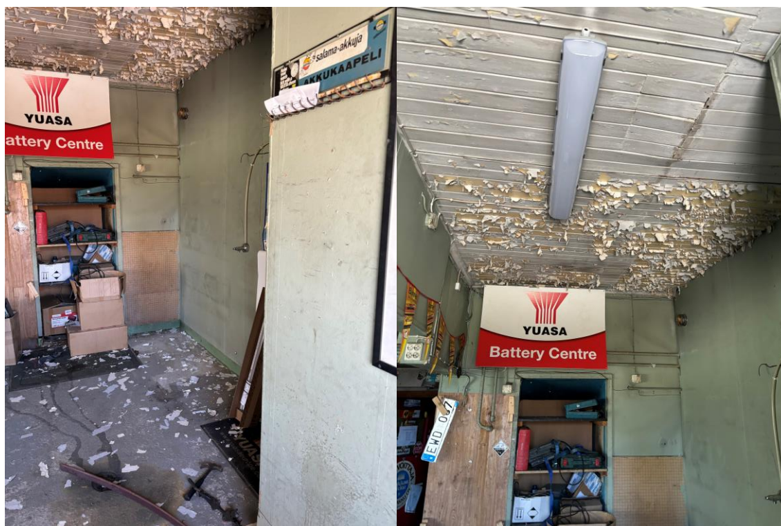
Välikaton kosteus irrottanut maalin katosta.
