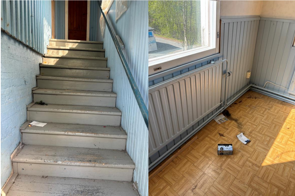
Portaikun runko pettänyt. Patteriverkosto vuotanut useammasta kohdasta.
