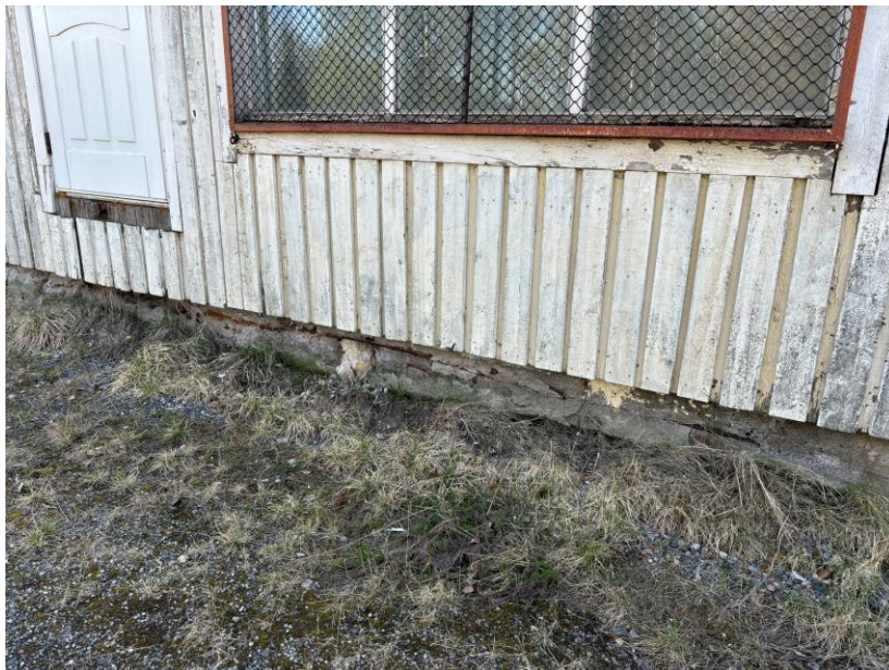
Ikkunoiden kunto heikko, pellitykset puuttuvat. Rännit ja syöksytorvet puuttuvat. Perustus on pettänyt.
