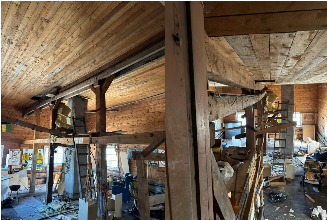
Katon kantava runko pettänyt ja taipunut notkolle.
