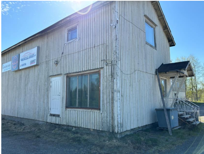
Ulkovuori rapistunut ja lahonnut. Portaat puuttuvat.
