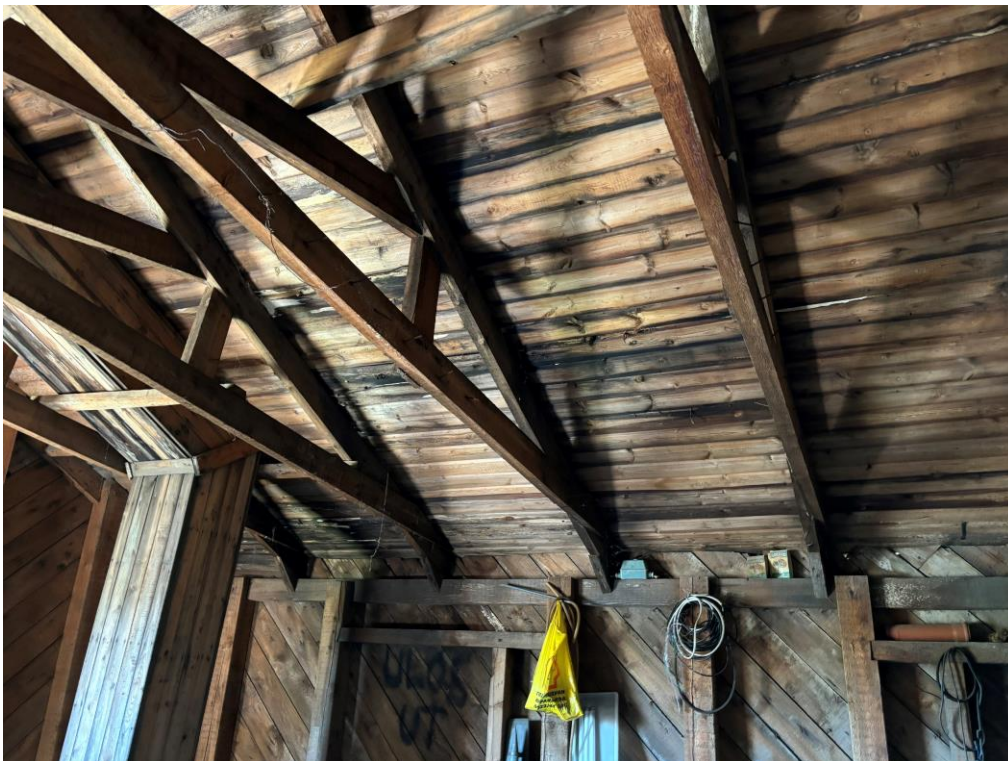
Vesikate vuotanut ja lahottanut kattorakenteita.
